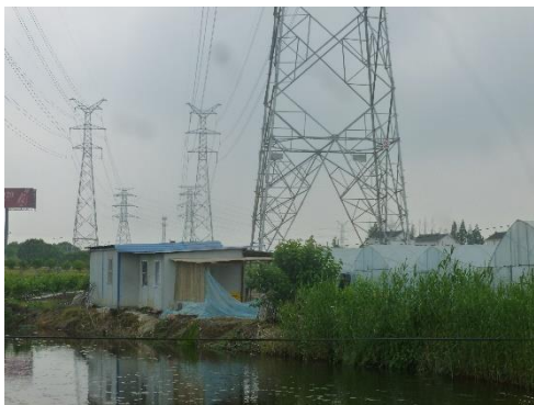
图6-1 本工程同塔双回架空线路
