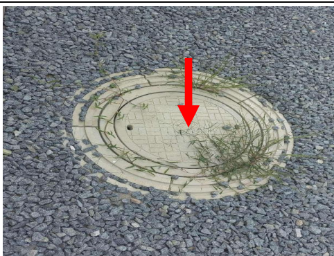
图 8-4 110kV 洪爽变化粪池照片
