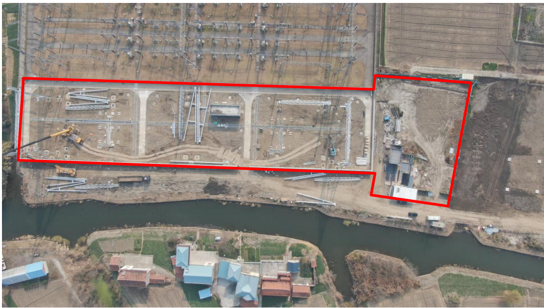
变电站扩建区图-12 月
