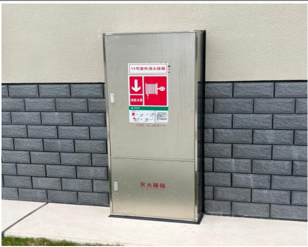
站内消防设施
