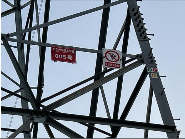
110kV 垦团 82C 线#5 杆塔警示与防护指示标志示例
