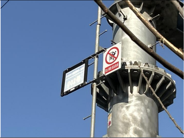
110kV 团阿 8L3#2 杆塔警示与防护指示标志示例
